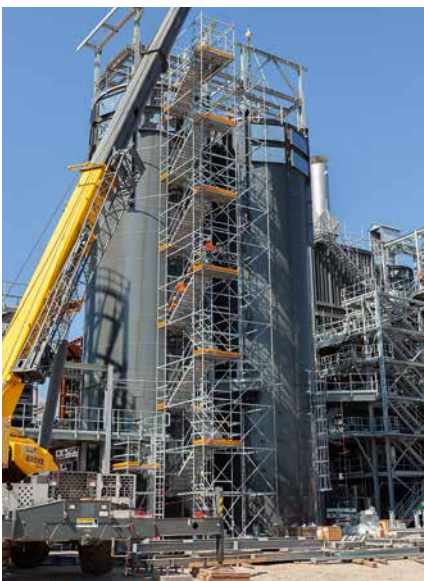
Las torres de escaleras con unidades alternadas proporcionan un mayor espacio libre sobre la cabeza y menores distancias que recorrer entre niveles para el personal.
