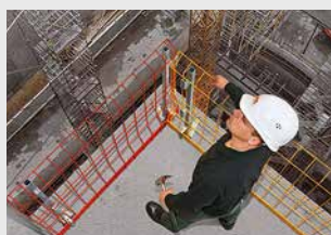
Sistemas de Seguridad
