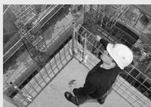
Sistemas de Seguridad
